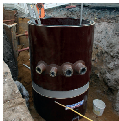
Speciale inspectieput met aansluitingen voor drukleidingen in het opzetstuk
